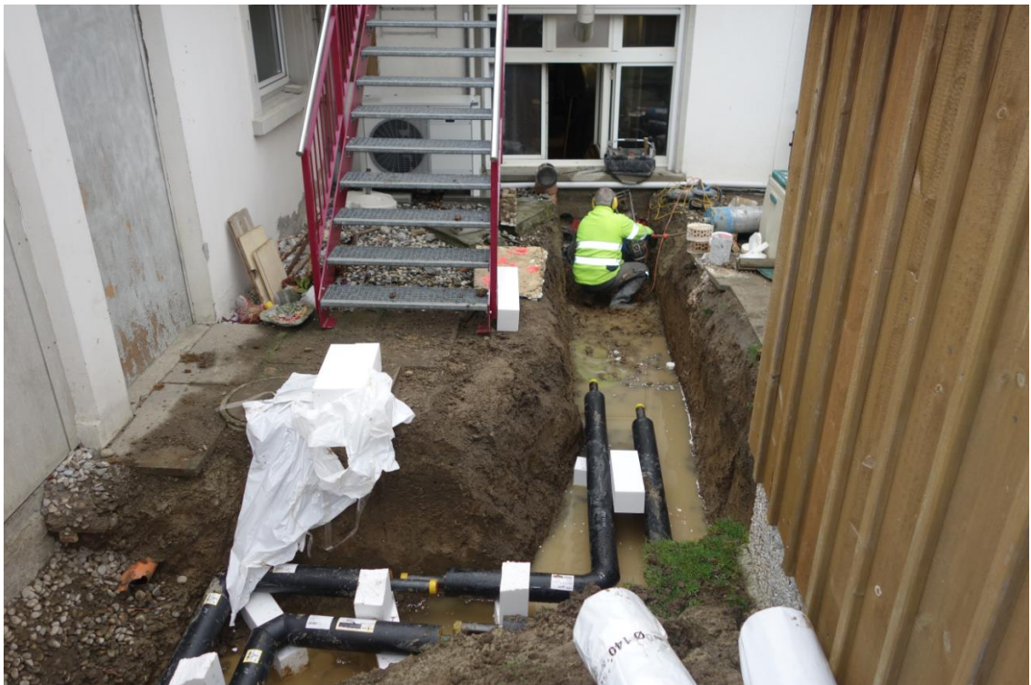
Bedingungen am Hauseintritt welche keine Schweissarbeiten zulassen
